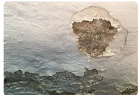
Afskallende maling og saltudtræk kan være tegn på fugt.
